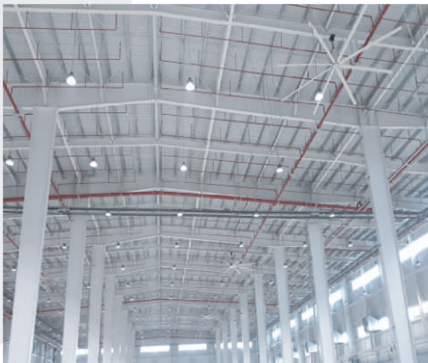
■ HỆ THỐNG ĐƯỜNG ỐNG CỨU HỎA NHÀ XƯỞNG
