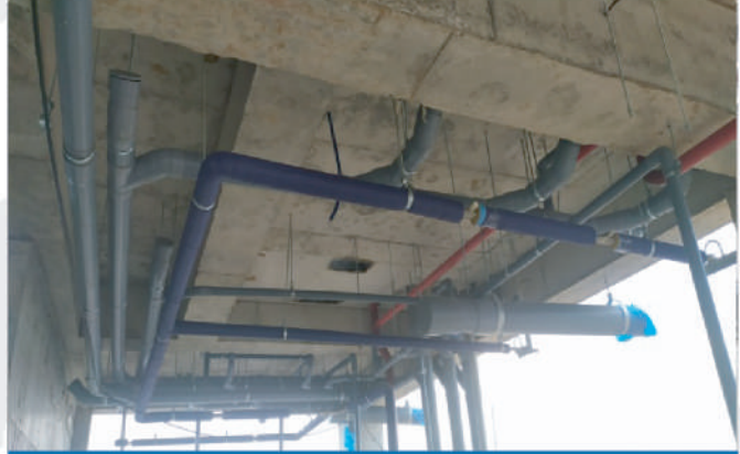
■ HỆ THỐNG ĐƯỜNG ỐNG CỨU HỎA NHÀ XƯỞNG
