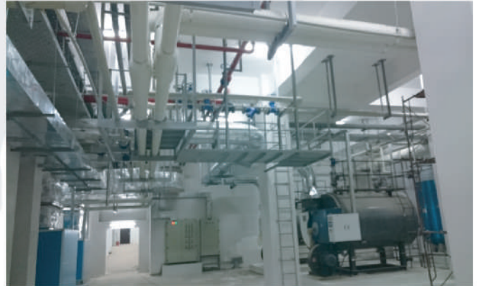
■ HỆ THỐNG ĐƯỜNG ỐNG TRONG PHÒNG CƠ KHÍ
