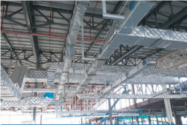
■ HỆ THỐNG ĐƯỜNG ỐNG CỨU HỎA NHÀ XƯỞNG
